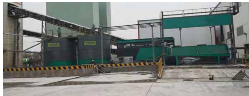
方案2：砂石分离机及浆水回收系统（浆水罐）
