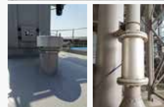
管囊阀压差计压力安全阀连续料位
