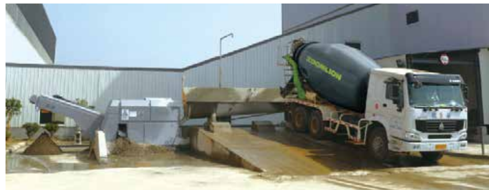
方案1：砂石分离机及浆水回收系统（浆水池）
