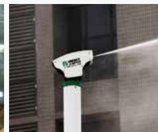
搅拌站室外抑尘系统
